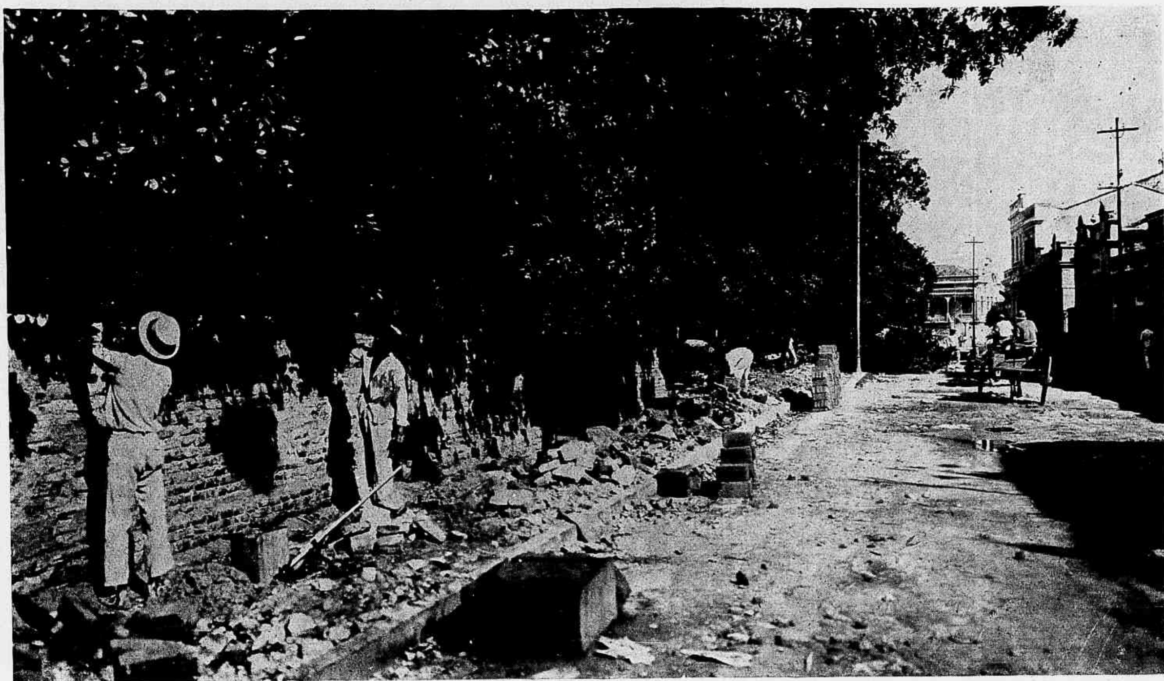
Rua Nunes Machado, durante os trabalhos de calçamento e alargamento executados na gestão do Sr. Costa Maia.
