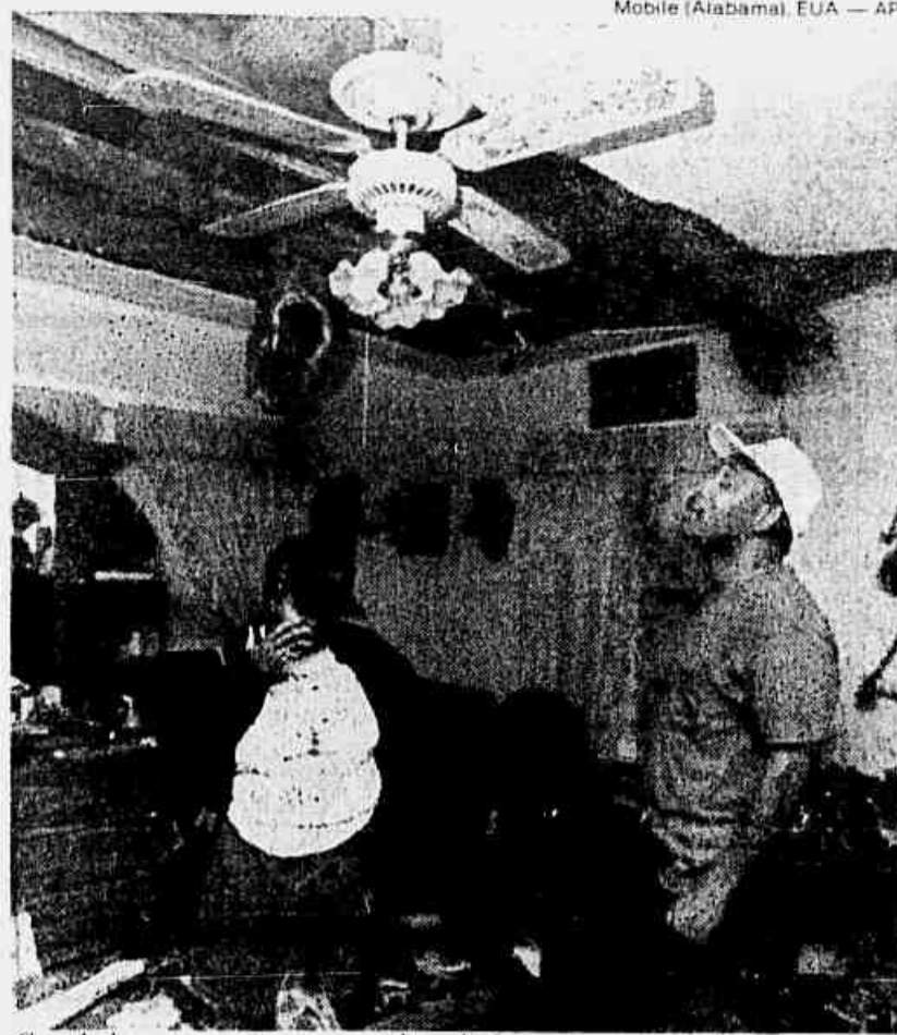
Casal observa o estrago causado pela árvore que caiu sobre sua casa
