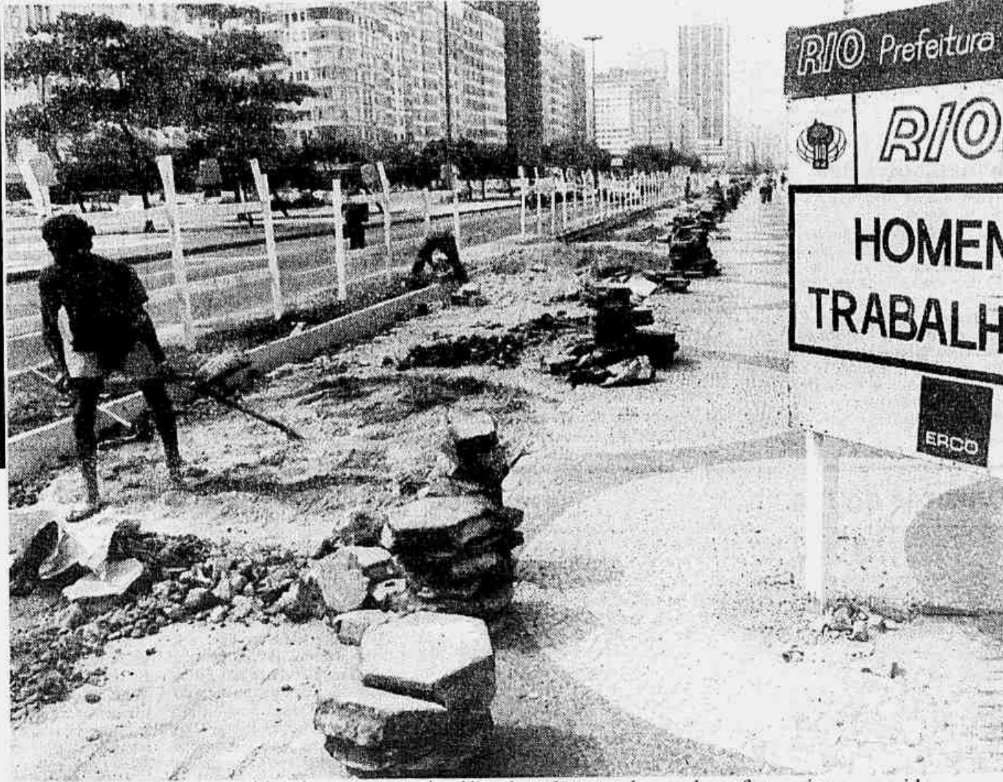
Vários recuos já tinham sido abertos nos calçadões da orla quando as obras foram interrompidas
