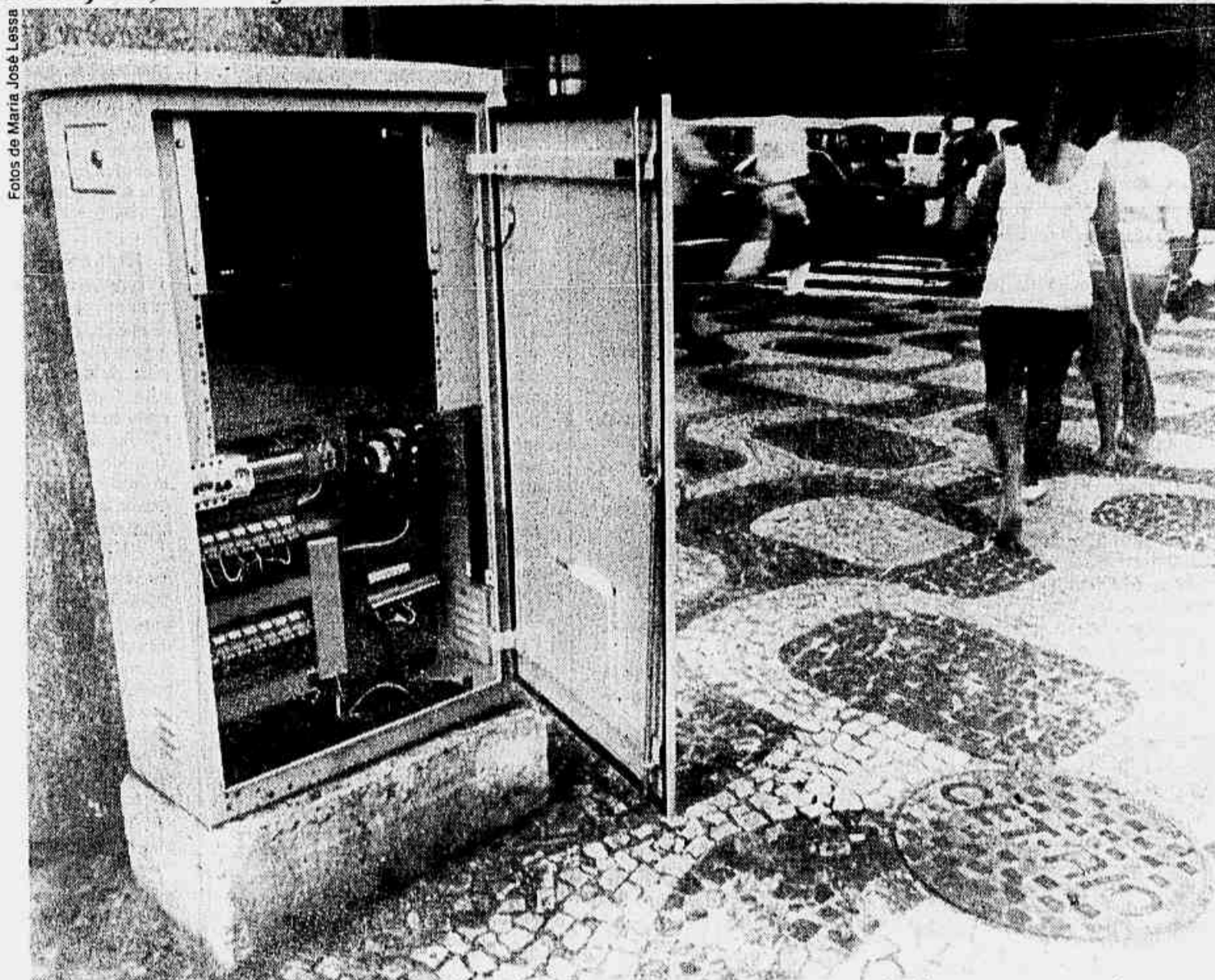
Através de reguladores de rua, painéis e câmaras, os sinais serão acompanhados por computador
