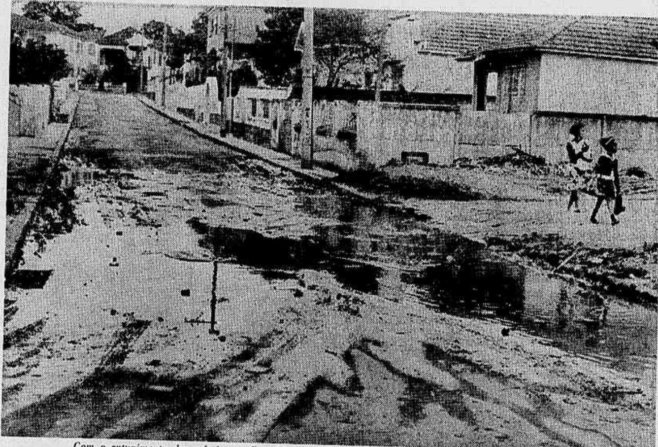
Com o entupimento das galerias na Rua César Marques foi fácil à chuva transformar buracos em lagos
